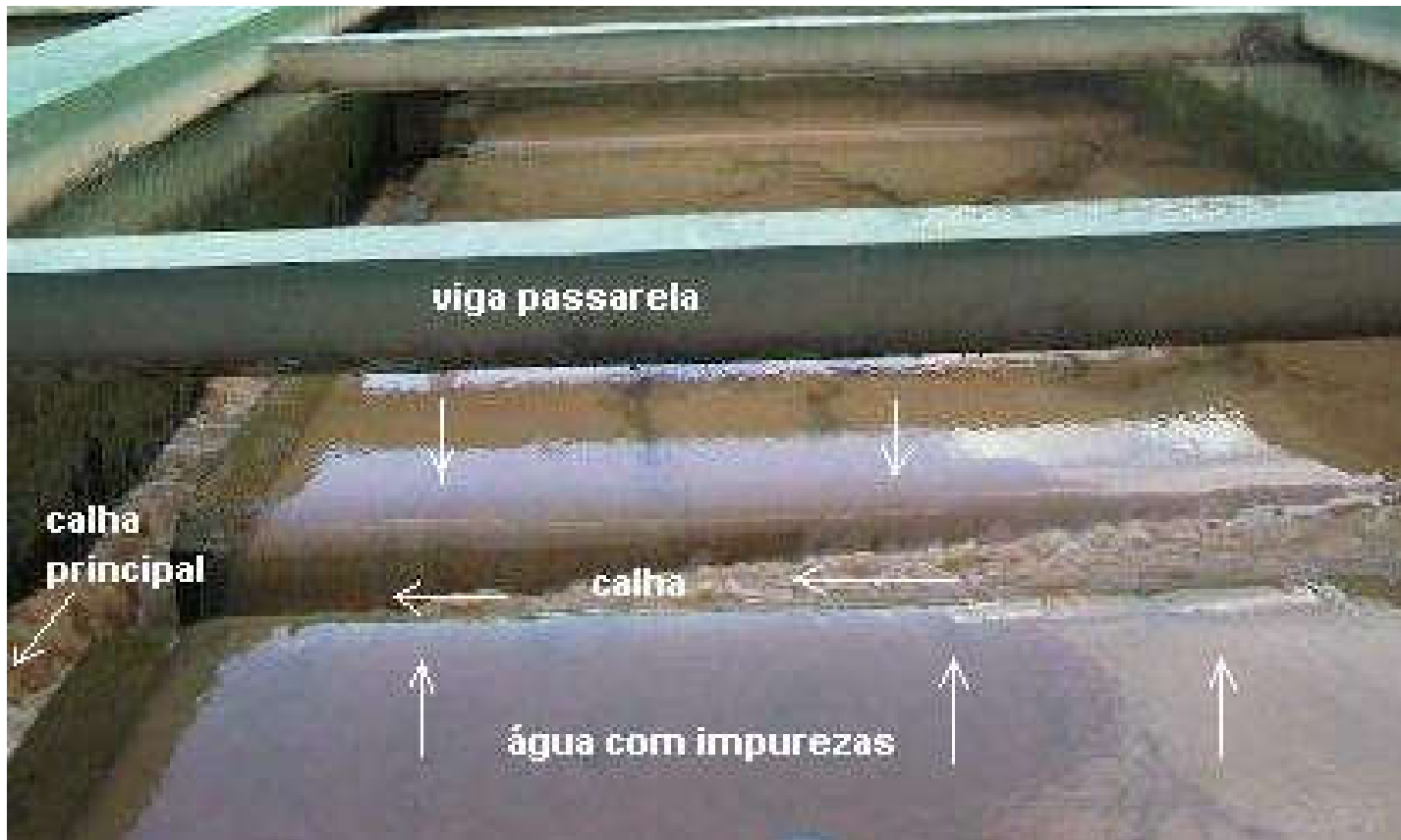
Lavagem de filtros
