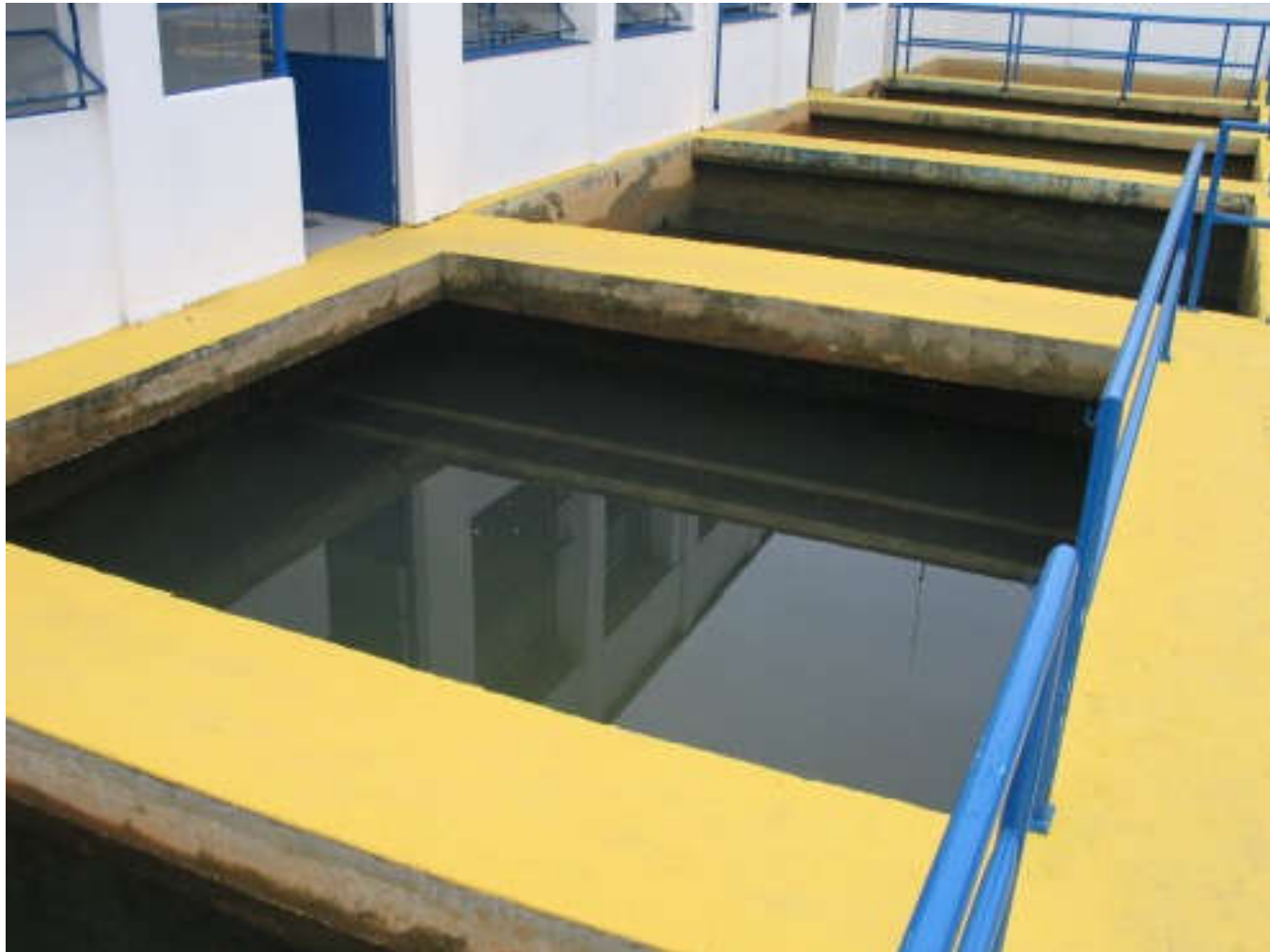
Vista parcial da bateria de filtros
